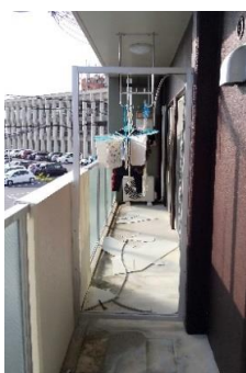
強風で 吹き飛んだ 「隔て板」
