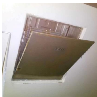
強風で壊れ 閉じなくなった 「避難ハッチ」
